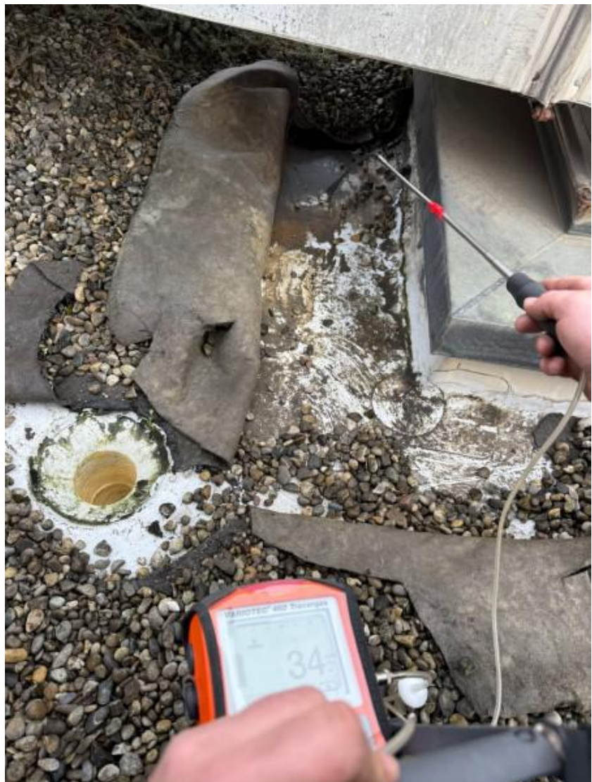
Abschnitt D: Beschädigung 1
