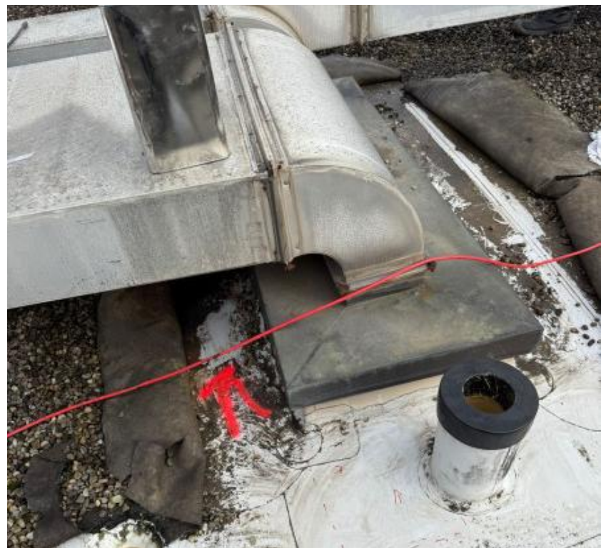
Abschnitt B: Lüftungskasten Abschnitt D: Beschädigung 1
