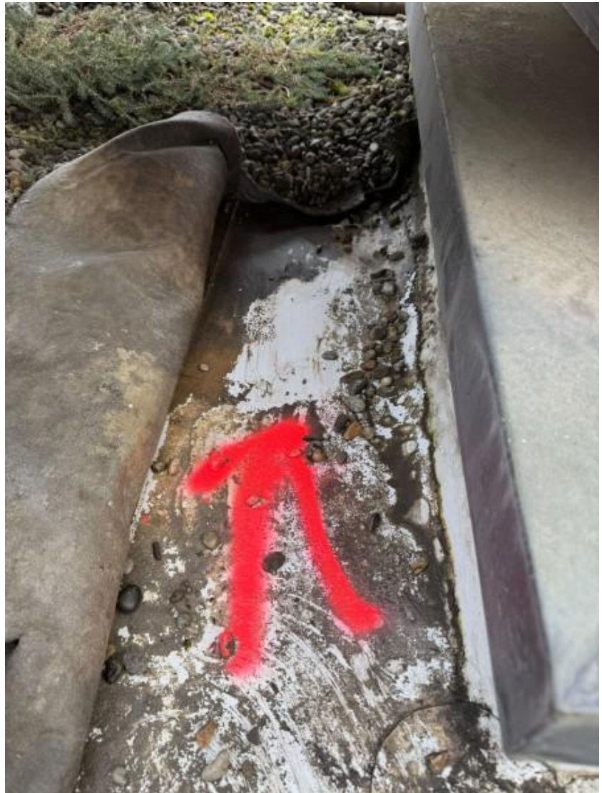
Abschnitt D: Beschädigung 1
