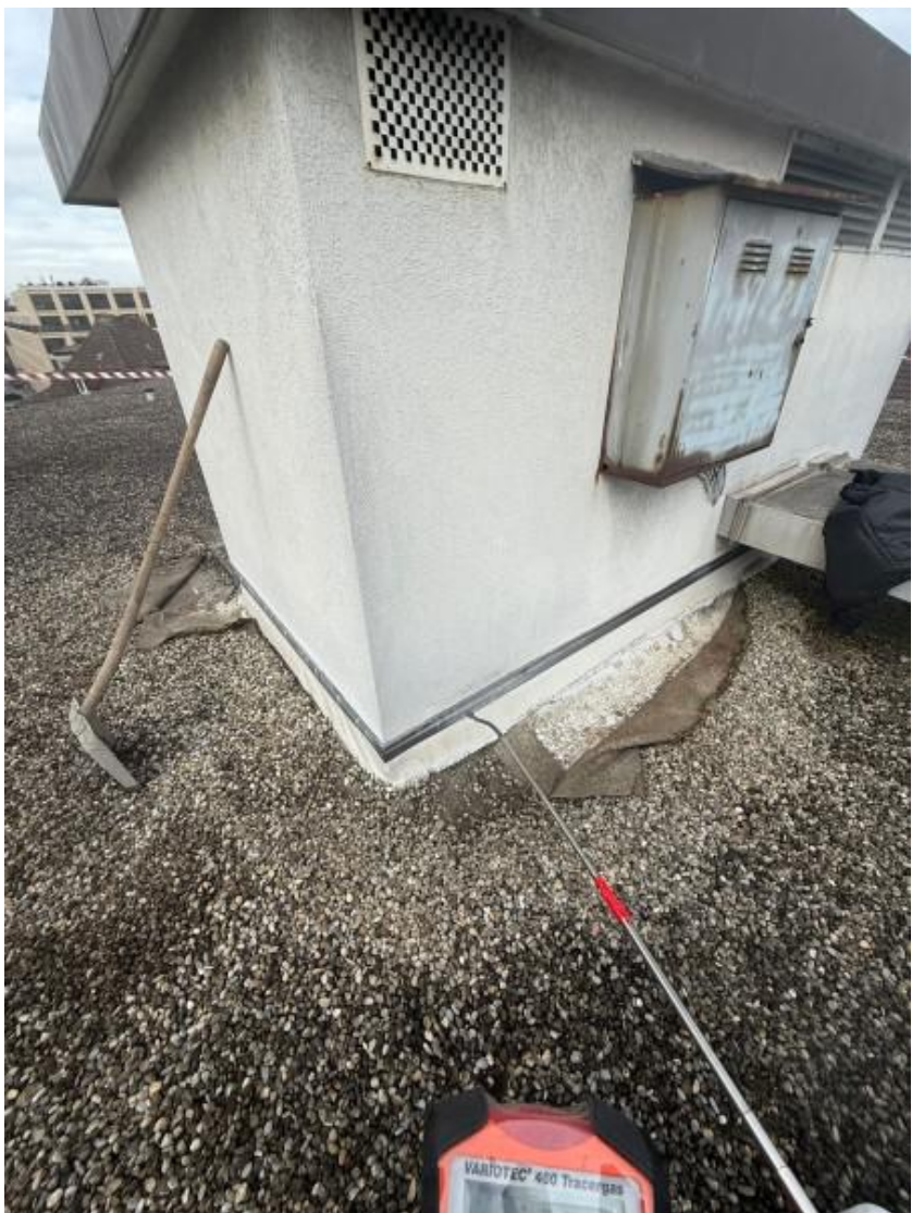
Abschnitt G: Abdichtungsfugen (starker Gasaustritt)
