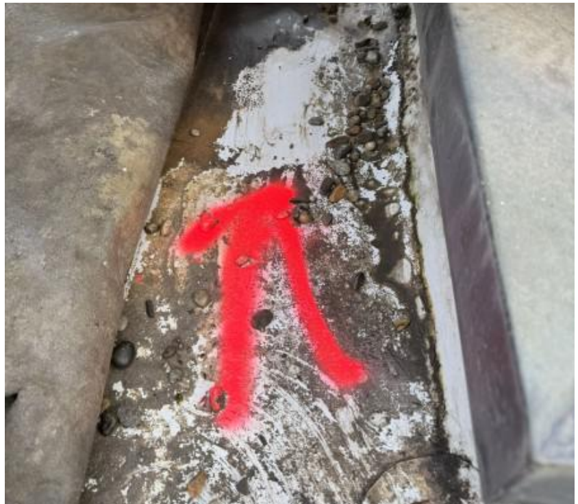
Abschnitt D: Beschädigung 1
