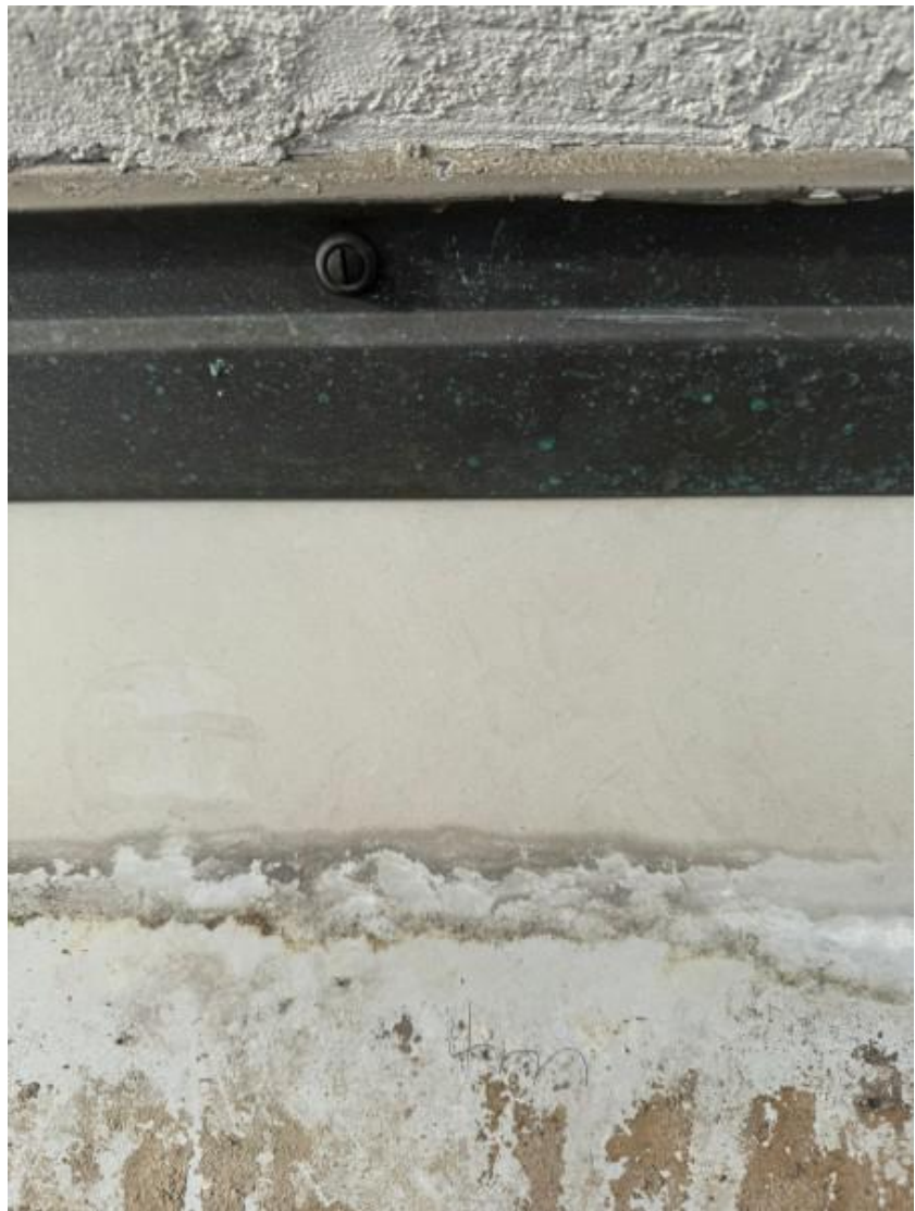
Abschnitt G: Abdichtungsfugen (starker Gasaustritt)
