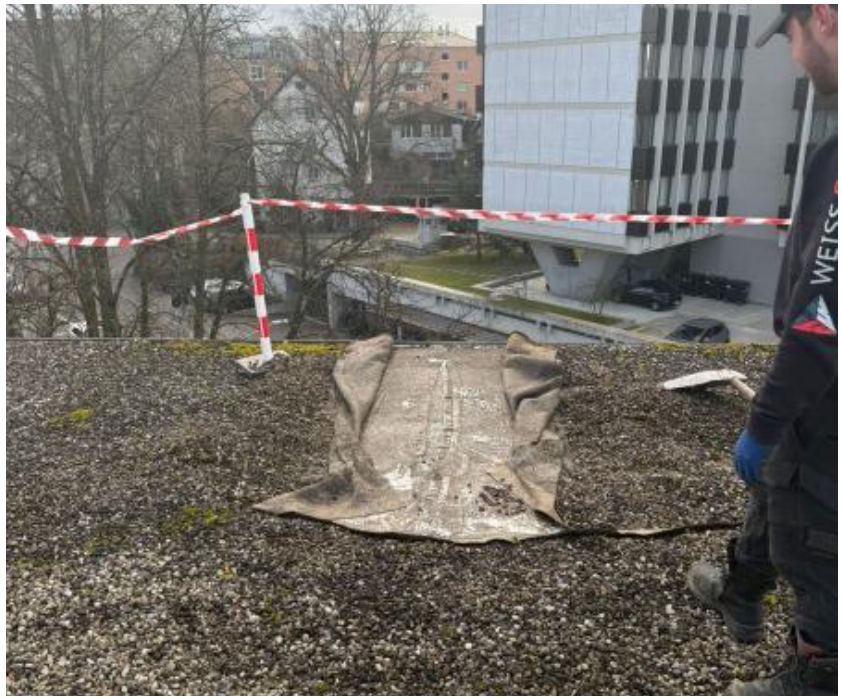
Abschnitt F: Beschädigung 3 (2 Meter langer Schnitt in Dachfläche)
