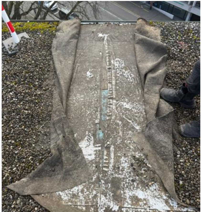
Abschnitt F: Beschädigung 3 (2 Meter langer Schnitt in Dachfläche)
