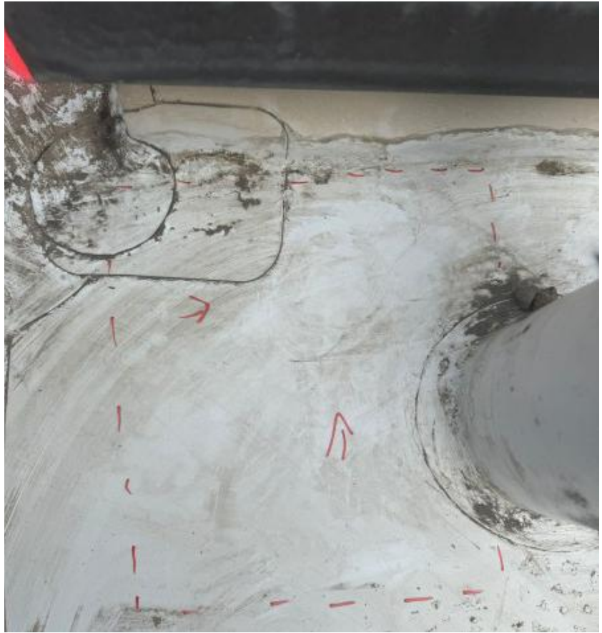
Abschnitt E: Beschädigung 2
