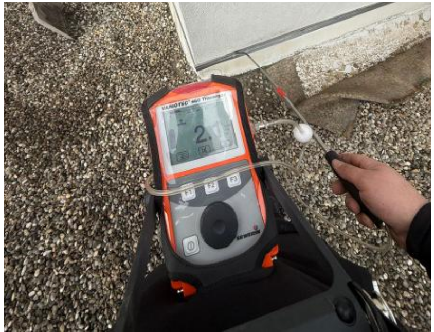
Abschnitt G: Abdichtungsfugen (starker Gasaustritt)
